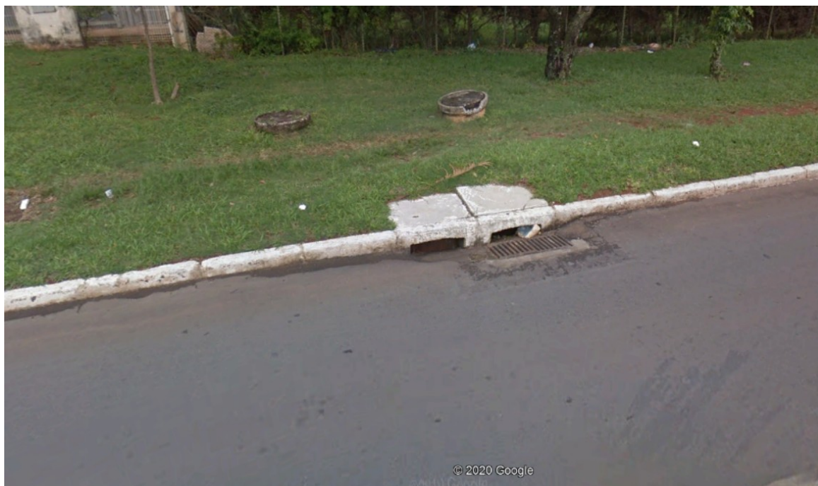
Figura 2 – Boca de Lobo Dupla – 1 com meio fio vazado e 1 mista
