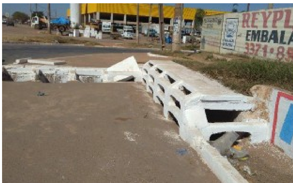
Figura 1 - Boca de Lobo Improvisada
