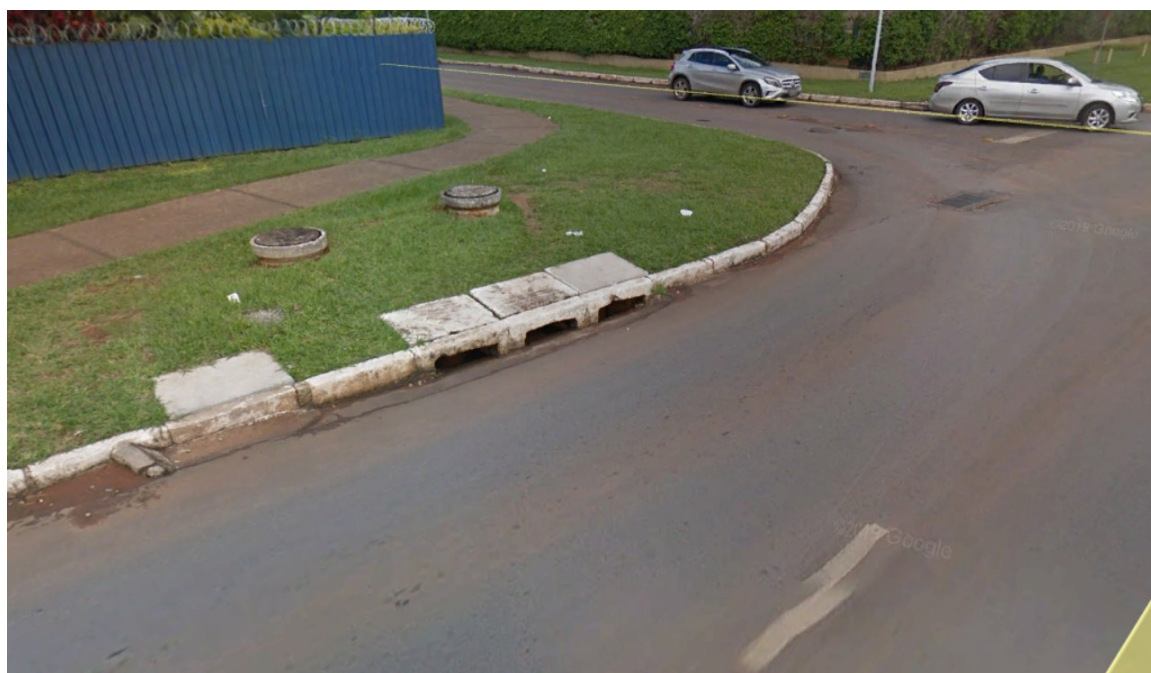
Figura 5 – Boca de Lobo Tripla com meio fio vazado
