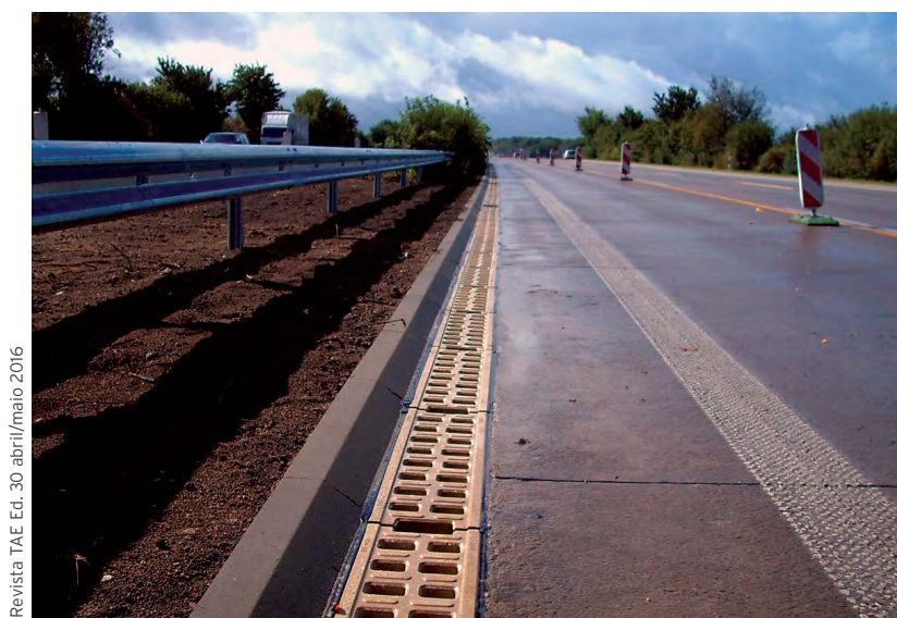
Figura 21 Captações Lineares de Águas Pluviais.
