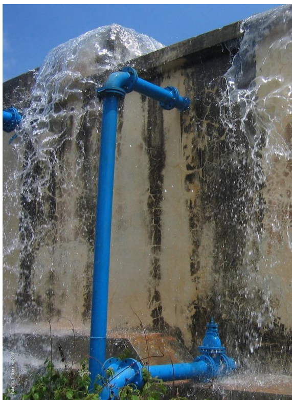
Figura 23 - Extravasamento de reservatório.
