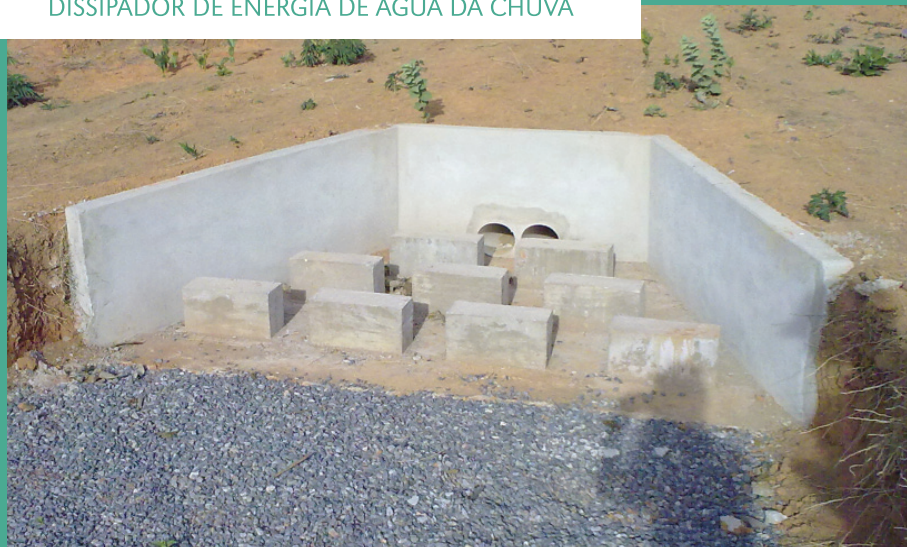
DISSIPADOR DE ENERGIA DE ÁGUA DA CHUVA
