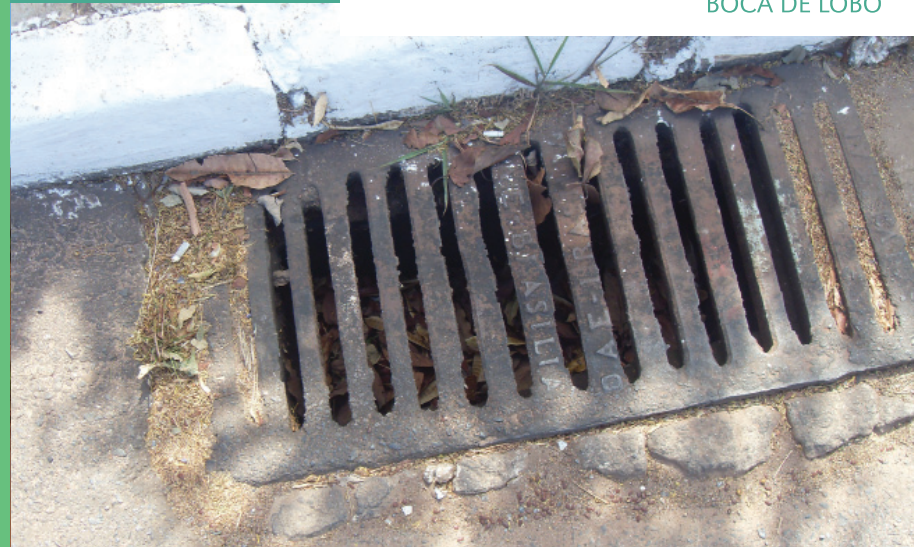
BOCA DE LOBO
