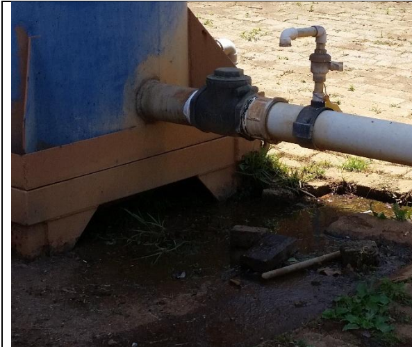
Foto 5 – Vazamento em uma das válvulas (RF/COFA/007/2015)
