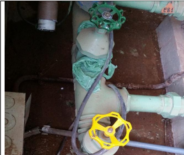
Foto 1 – Saco plástico usado na tentativa de contenção de vazamento (RF/COFA/007/2015).
