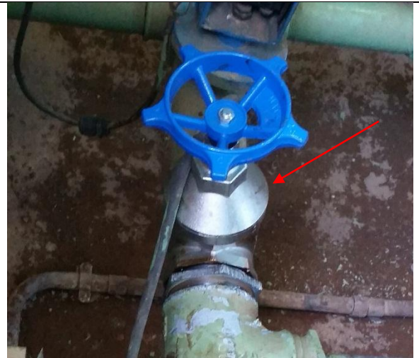
Foto 2 – Vazamento contido e registro substituído.
