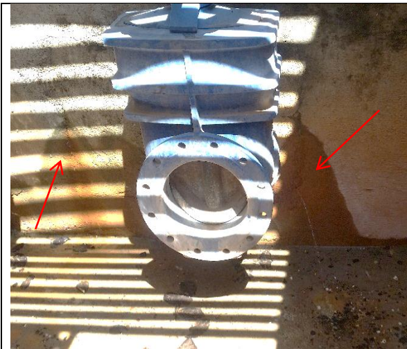
Foto 3 – Sinais de rachaduras e vazamentos na base do RAP.SSB.001 (RF/COFA/007/2015).
