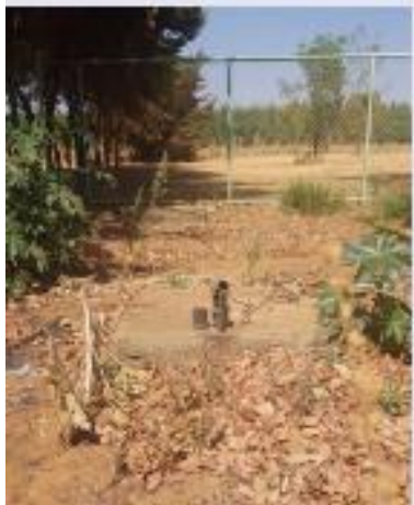
Foto 4 – Fossa séptica com suspiro improvisado
