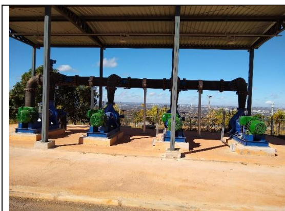
Foto 1 – Conjuntos de motobomba do Booster EBO.TAQ.003.
