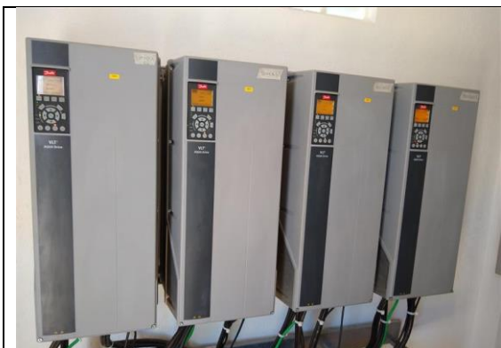
Foto 3 – Inversores de frequência dos motores
