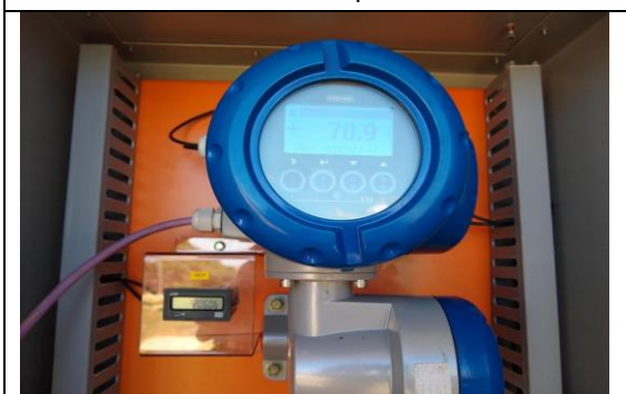
Foto 5 – Display do medidor de vazão da tubulação de saída
