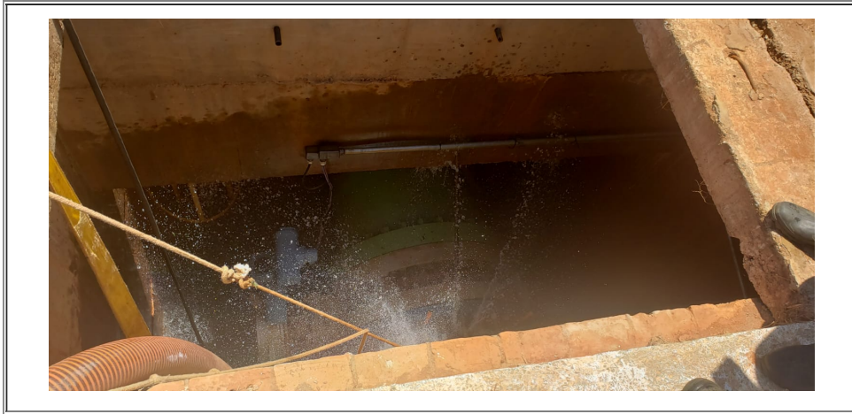
Foto 1 - Vazamento na válvula da adutora
