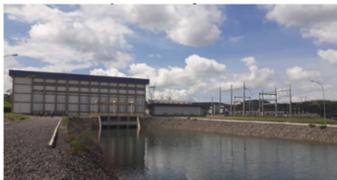
Captação e Elevatória de Água Bruta
