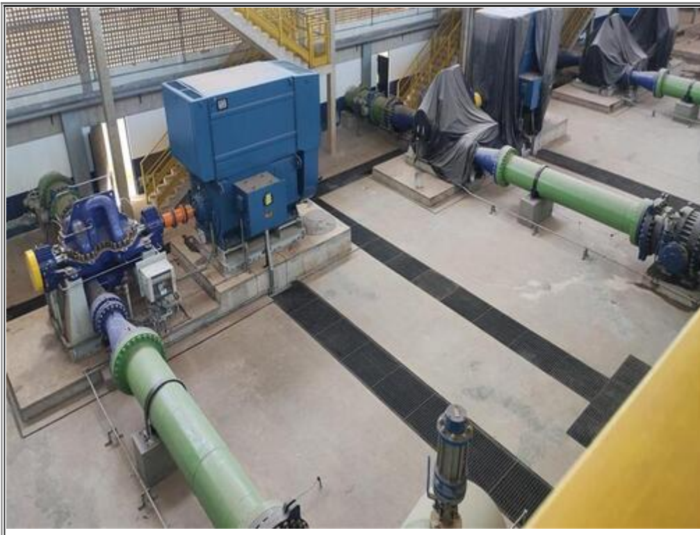
Foto 8 - Motores da Estação Elevatória de Água Tratada
