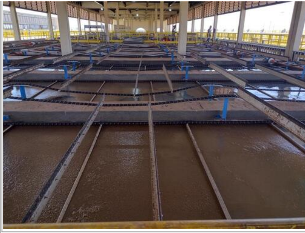
Foto 7 - Flotadores da ETA Corumbá
