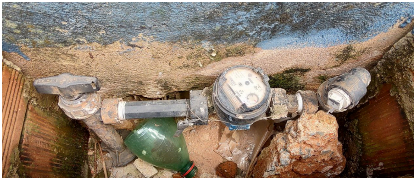
Foto 4: Hidrômetro protegido por alvenaria, em frente aos lote 11 (muro azul) - da Qd 08 – SIC, Ceilândia/DF
