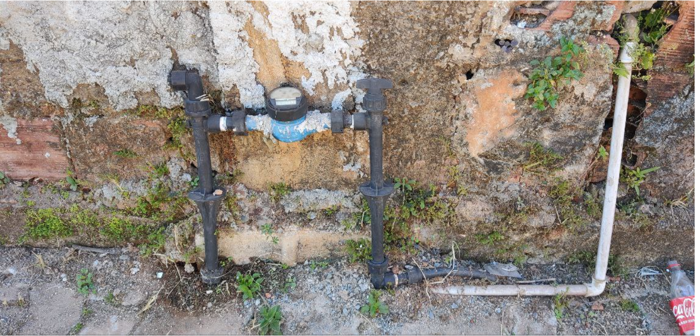
Foto 3: Cavalete do hidrômetro - Ch 28 Casa 01-A Sucupira - Riacho Fundo - DF
