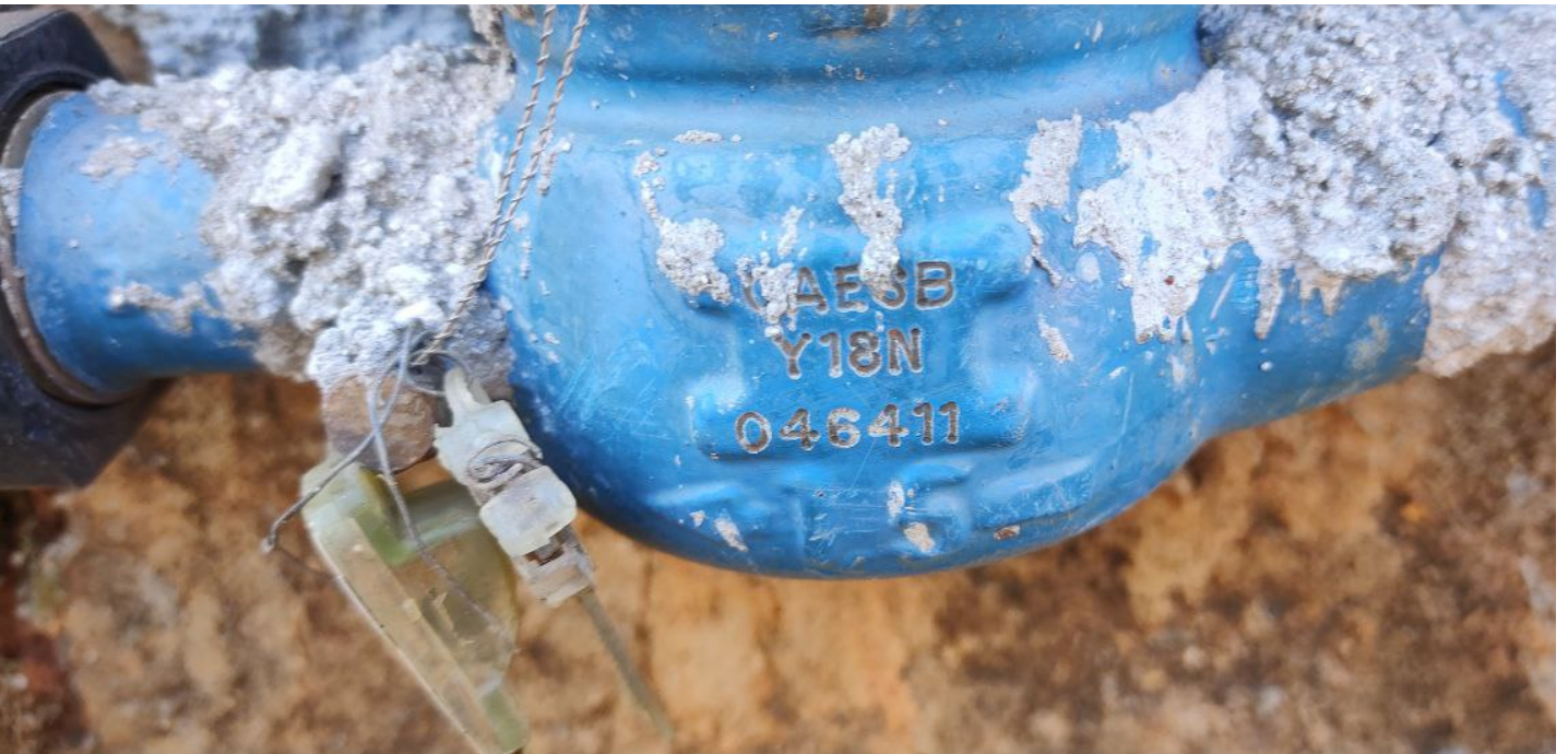
Foto 4: Número de identificação do hidrômetro da unidade Ch 28 Casa 01-A Sucupira - Riacho Fundo - DF
