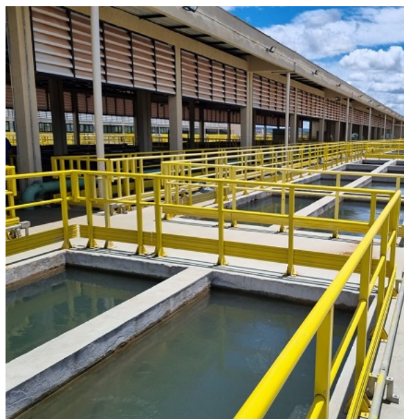
Foto 2 - Estação de Tratamento de Água - ETA COFA
