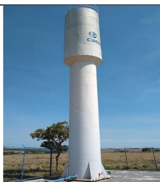
Foto 6 – Reservatório N.R. Capão Seco
