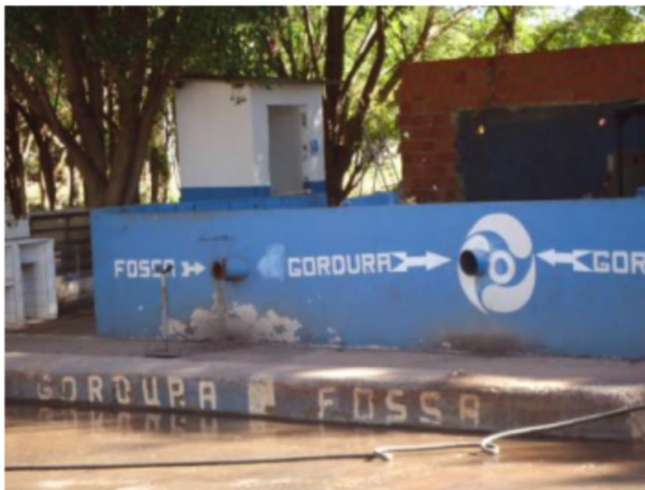
Figura 1: ETE adaptada para recebimento do lodo do caminhão limpa fossa
