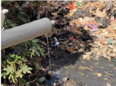
Lançamento de esgoto a céu aberto na comunidade de Manoel Dias Branco, em Fortaleza (Foto: Divulgação/Instituto Trata Brasil).
