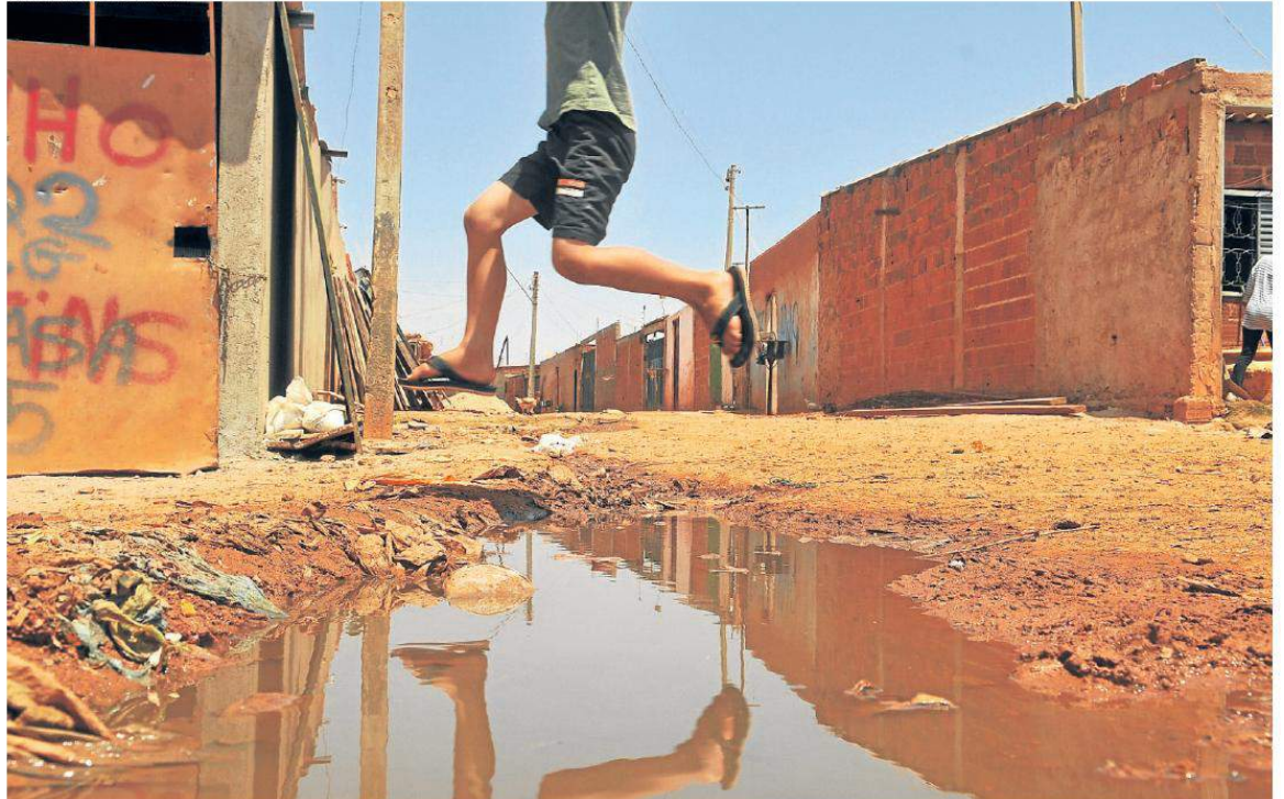
O esgoto ainda é um problema para o poder público: nem metade dos brasileiros têm acesso ao serviço; população fica exposta a doenças
