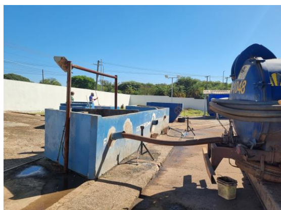
Figura 20 | Detalhe do mangote no local destinado ao descarte para lodo de fossas.
