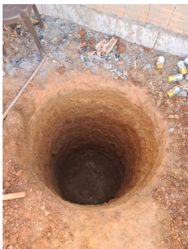
Figura 12 | Processo de perfuração de “Fossa” sem seguir recomendações da NBR 7.229 (Ch. 48 – Pôr do Sol).
