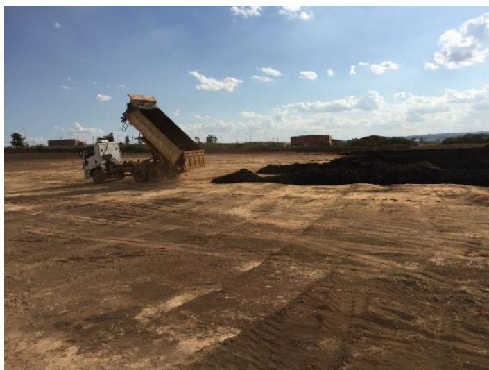
Figura 79 - Deposição de lodo desidratado.
