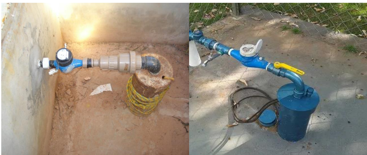
Figura 8.8-1: Exemplos de Poços tubulares
