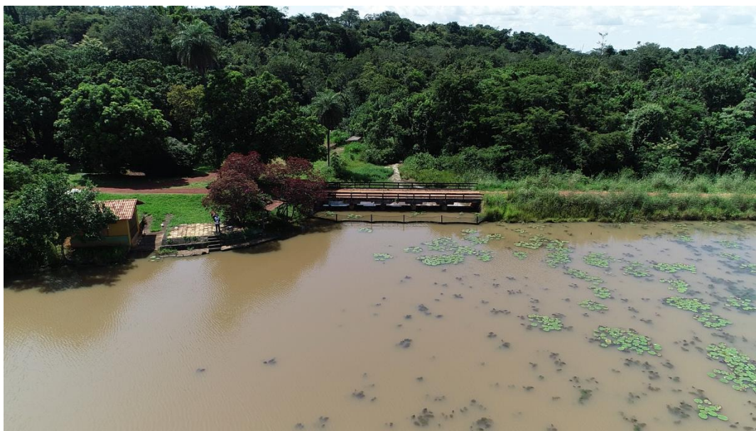
Figura 10-2: Exemplo de Vertedouro de soleira livre: Barragem Vale Verde, Águas Lindas/GO
