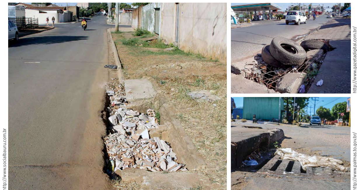
Figura 7 Impactos de lançamentos de resíduos sólidos em bocas de lobo e redes de drenagem urbana.
