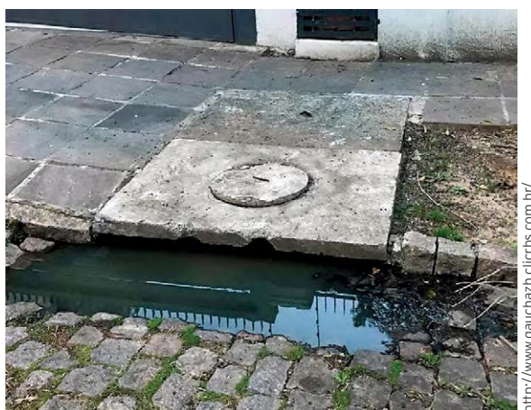
Figura 9 Impactos de lançamentos de águas pluviais em redes de esgotos.
