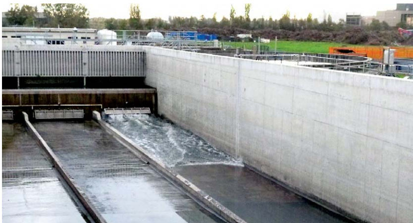
Figura 147 Reservatório de água de primeira chuva com sistema hidráulico automático de remoção de sedimentos em Milão, Itália.
