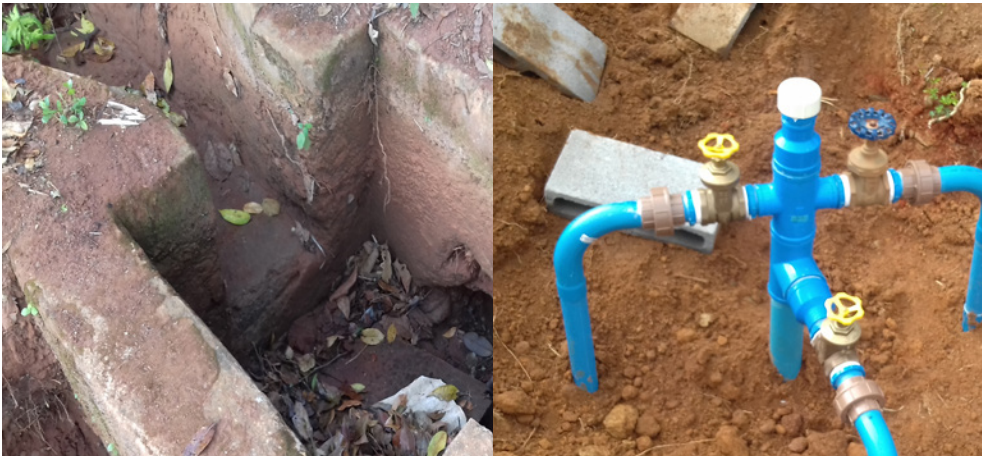
Figura 6. Como era e como está sendo feita a distribuição de água no canal de irrigação do Santos Dumont em Planaltina/DF
