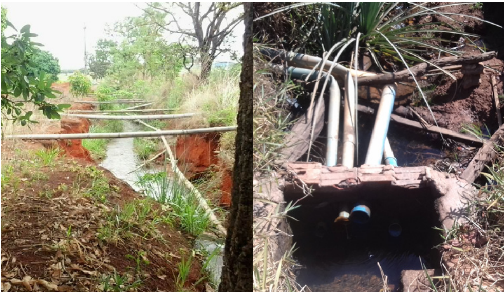
Figura 1. Canais de irrigação sem revestimento na área rural do Distrito Federal mostrando erosão do solo e falta de manutenção das estruturas
