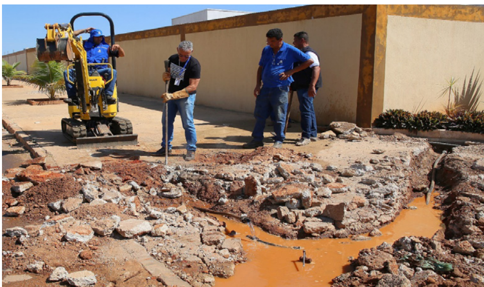
Figura 4. Retirada de ligação clandestina de água em Arniqueiras, agosto/2018
