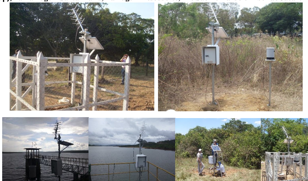
Figura 32. Estações telemétricas instaladas no rio São Bartolomeu (Faz. Recreio), rib. Pipiripau (Frinocap), na Barragem Santa Maria, Barragem Descoberto, Rio São Bernardo e Ribeirão Jacaré
