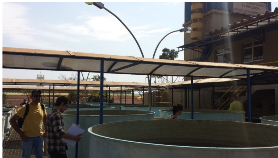
Figura 21 – Estação de Tratamento de Água de Brazlândia – Filtros e decantadores
