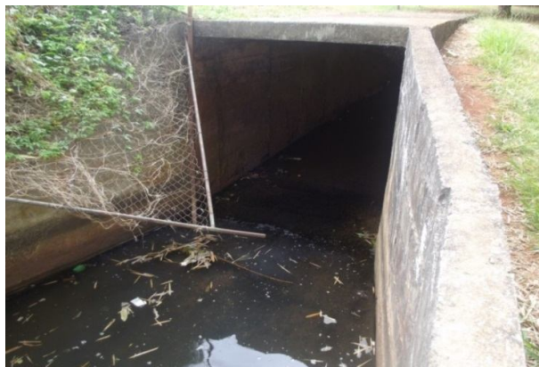
Figura 17 - Lançamento de águas pluviais no Lago Paranoá – ASFUB.
