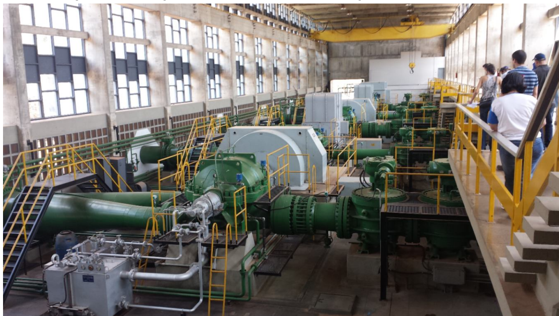
Figura 22 – Barragem Descoberto – Elevatória de Água Bruta – Vista Interior
