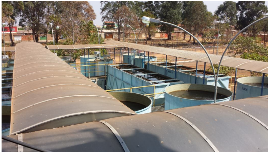
Figura 20 – Estação de Tratamento de Água de Brazlândia – Tanques Floculadores
