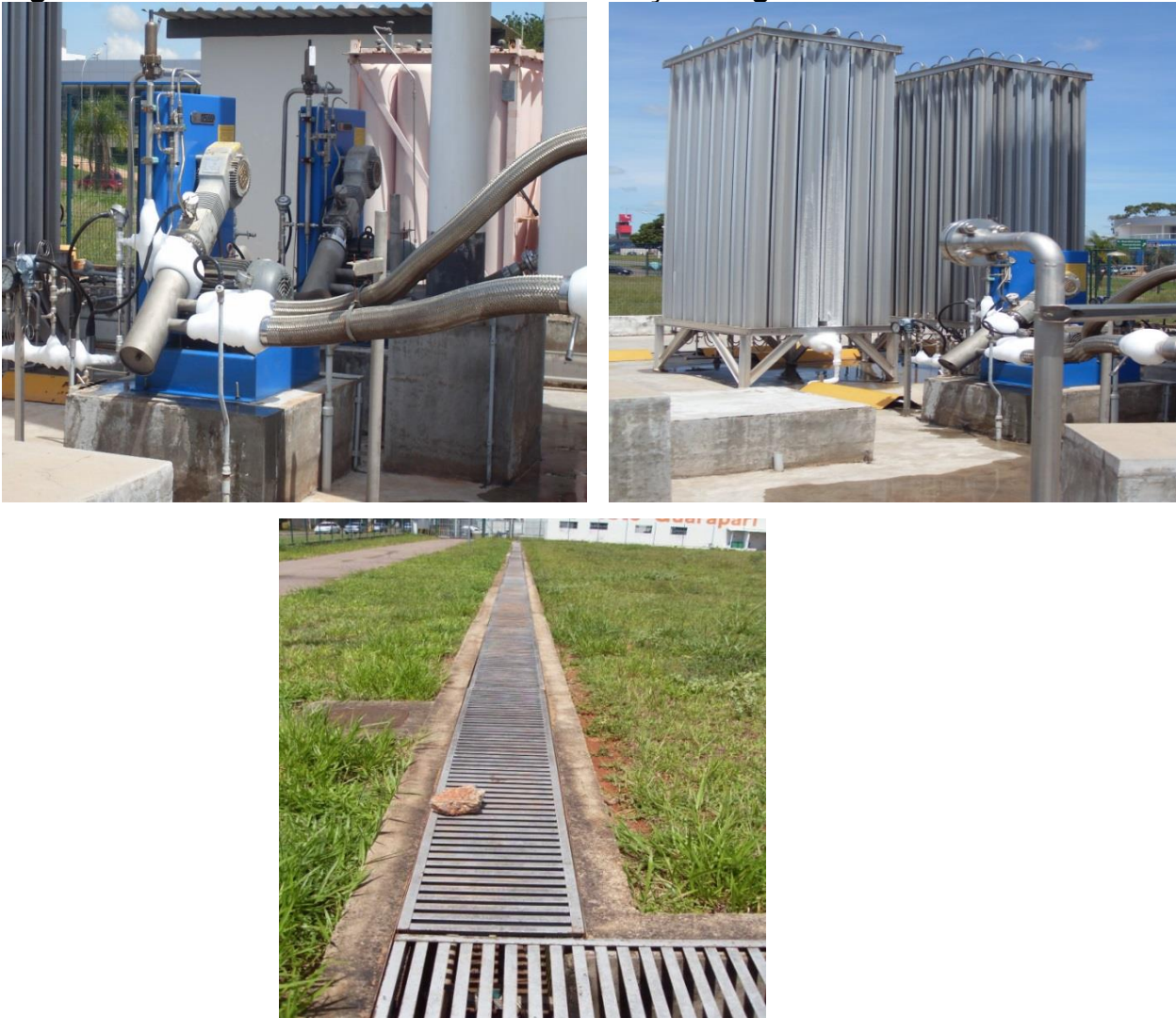
Figura 18 - estruturas do sistema de distribuição de gás canalizado.
