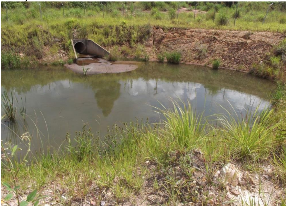
Figura 16- Estrutura de saída de bacia de retenção de águas pluviais (Bacia 04-Taquari BR 020)- DF.
