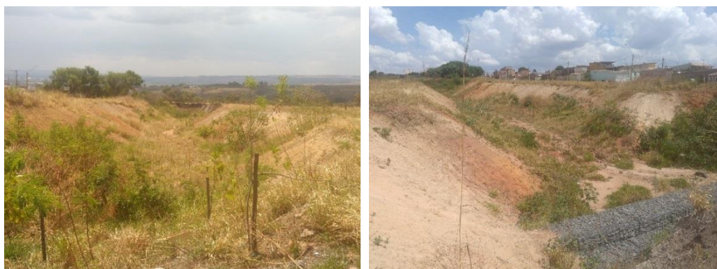
Figura 21 - Erosões em Ceilândia (Condomínio Privê) - situação atual.
