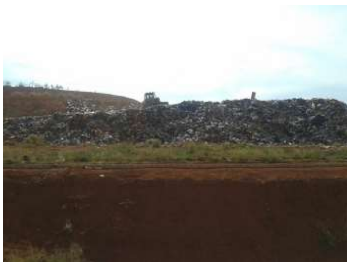
Figura 75 - Frente de serviço lateral do Aterro de Cidade Ocidental em junho de 2016. Fonte: SERENCO.
