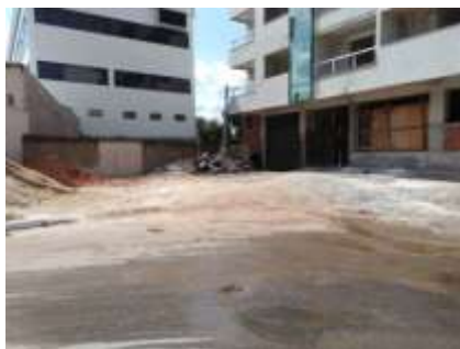
Figura 171 - Obra em execução sem medidas de controle de sedimentação - Vicente Pires. Fonte: SERENCO.
