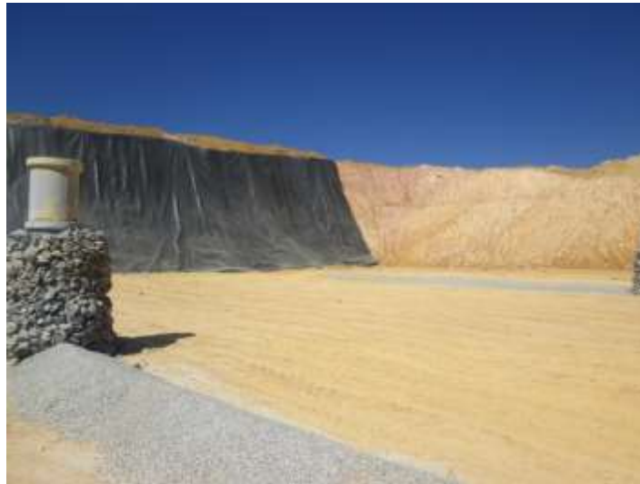
Figura 65- Drenagem de percolado e de gases da área de depósito (julho de 2016). Fonte: SERENCO.
