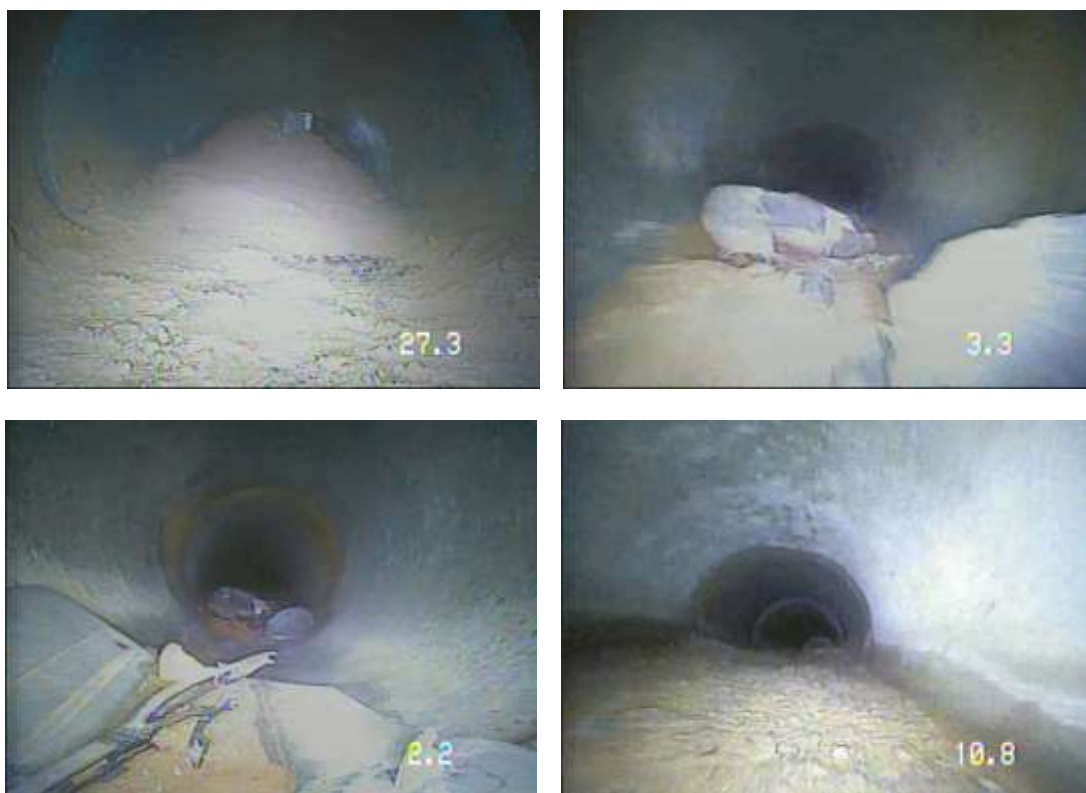
Figura 172 - Tubulação de drenagem pluvial obstruída com resíduos (Quadra 613 Asa Sul).
