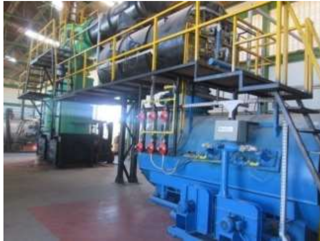
Figura 83 - Incinerador de RSS. Fonte: SERENCO.
