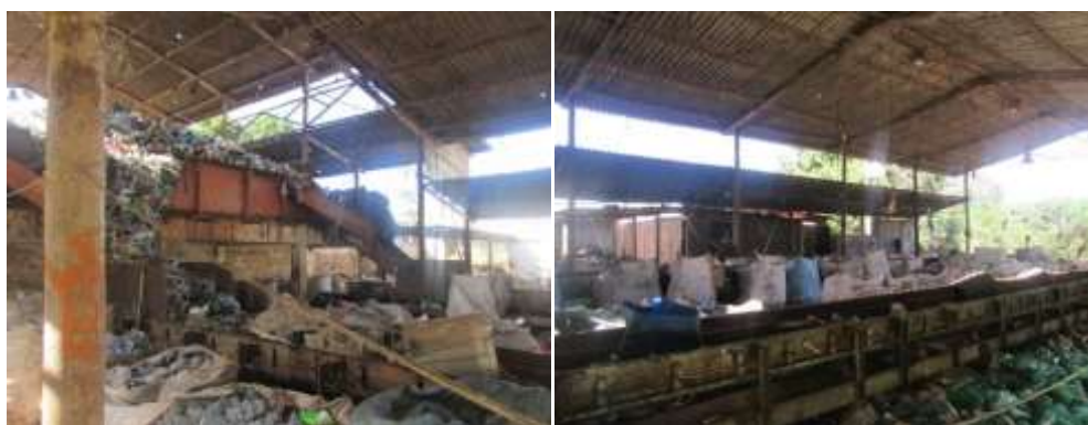
Figura 6 - Infraestrutura interna do galpão de triagem.
