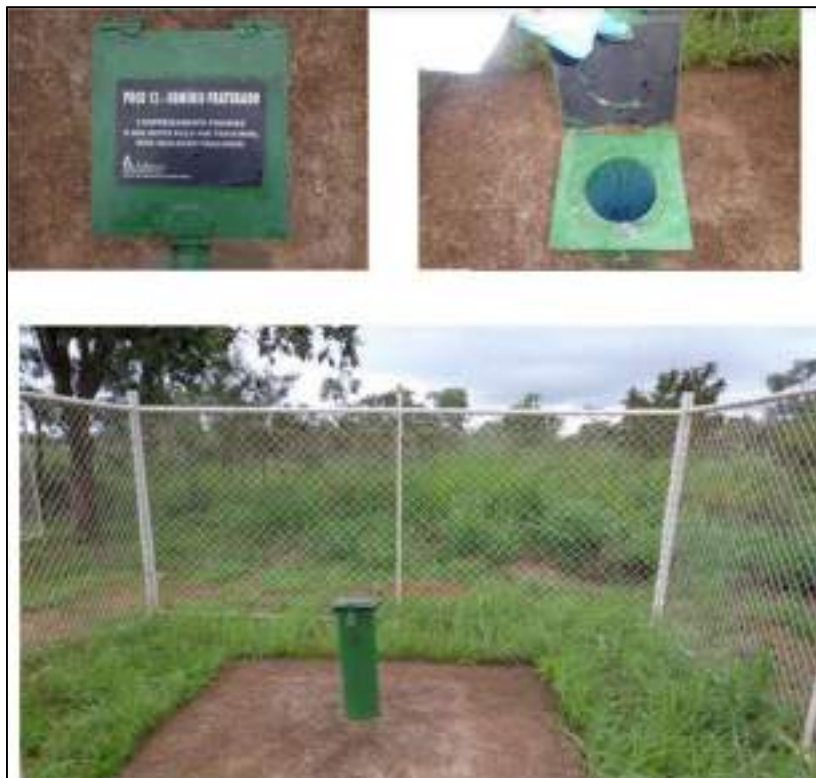
Figura 12.10 - Poço de monitoramento da Adasa. Fonte: Adasa (2023).
