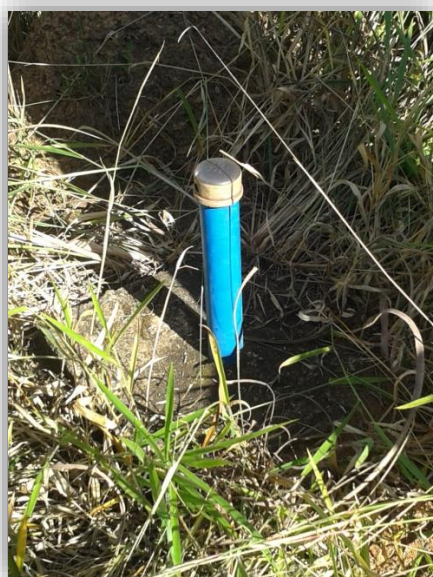
Figura 5 – Poço de monitoramento poço.
