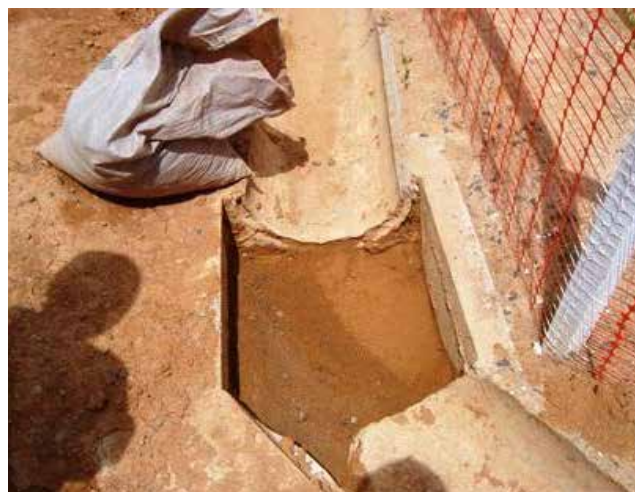
Figura 50 Sistema de retenção de sedimentos em calha de drenagem. Fonte: Rosa (2013)
