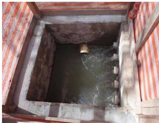
Figura 42 Caixa de passagem para aferição da qualidade da água de drenagem da obra antes do descarte. Fonte: Rosa (2013)
