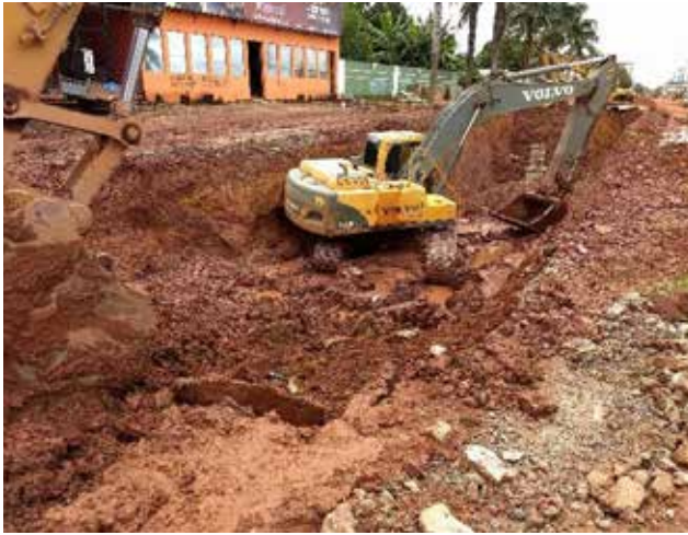
Figura 5 Via de circulação de veículos sem proteção e estabilização dos taludes. Fonte: SDU/Adasa (2019)
