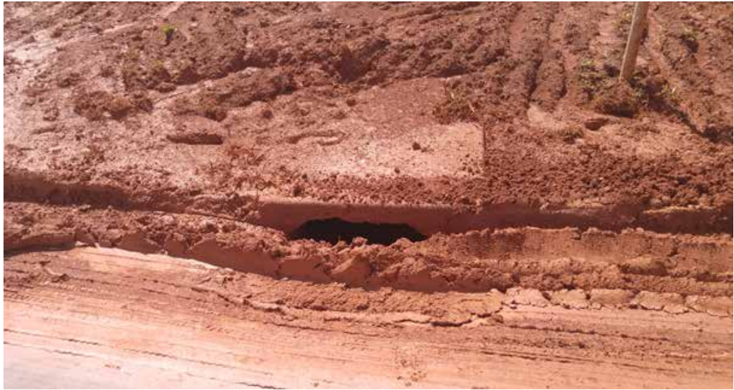
Figura 2 Boca de lobo tomada por sedimentos de obra de reforma de gramado na Avenida W3. Fonte: SDU/ADASA (2018)
