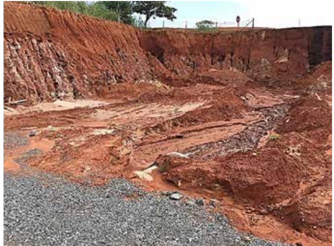
Figura 6 Taludes com sulcos de erosão e solo revolvido. Fonte: Rosa (2019)
