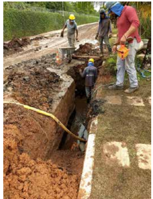
Figura 8 Abertura de vala, com disposição de solo lateralmente e necessidade de esgotamento de água proveniente do lençol freático. Fonte: SDU /Adasa (2019)
