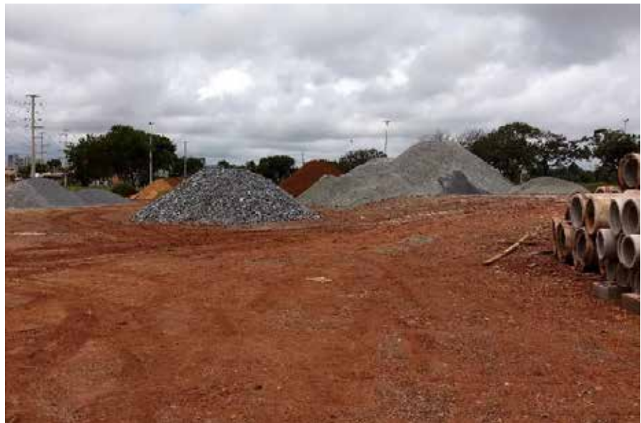
Figura 10 Estocagem inadequada de matérias-primas em canteiro de obras. Fonte: SDU /Adasa (2019)
