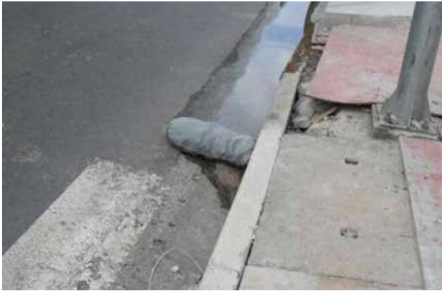
Figura 51 Sistema de retenção de sedimentos em calha pluvial da drenagem urbana. Fonte: Rosa (2013)
