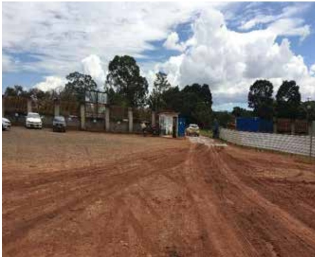
Figura 18 Exemplo de obra do tipo em rede ou malha para execução de rede coletora de esgotos sanitários. Fonte: Rosa (2019)
