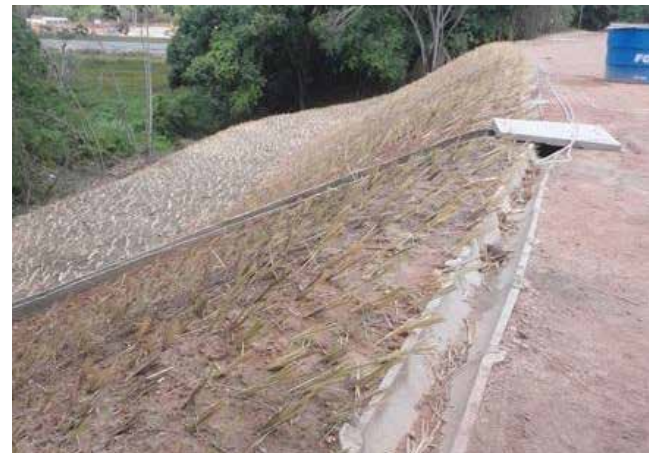
Figura 58 Talude com calha de crista instalada imediatamente após conclusão da terraplenagem. Fonte: Rosa (2013)
