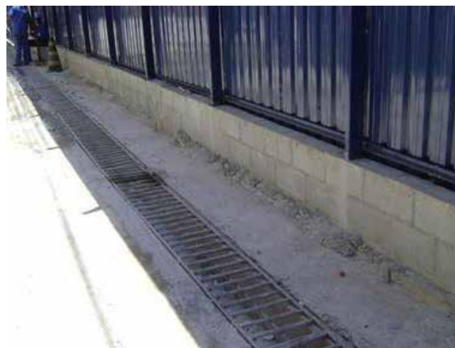
Figura 21 Tapume metálico do canteiro de obras com duas fiadas de bloco de concreto vedando sua base, com a existência de calha perimetral instalada. Fonte: Rosa (2013)
