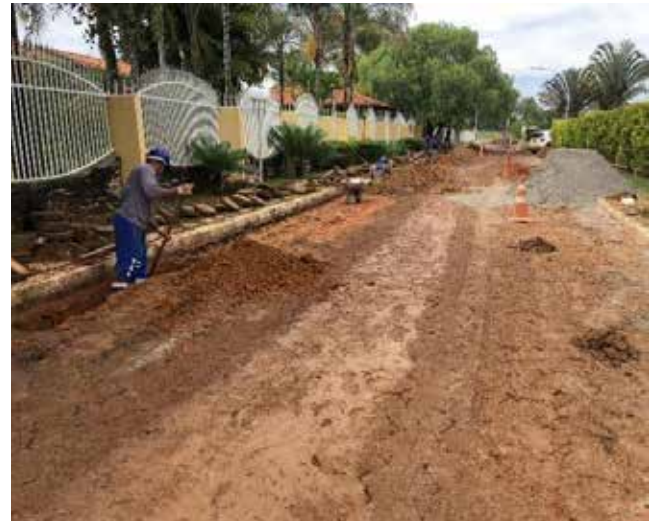
Figura 19 Exemplo de canteiro de serviços em obras de rede coletora de esgotos sanitários. Fonte: Rosa (2019)
