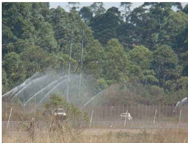
Figura 39 Sistema de umedecimento de via de circulação por aspersores fixos. Fonte: Rosa (2013)
