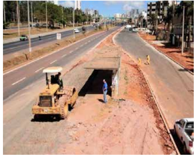
Figura 17 Obra na marginal Vicente Pires com solo exposto suscetível ao carreamento pluvial. Fonte: Agência Brasília (2019)
