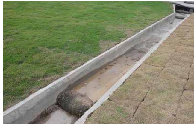
Figura 52 Sistema de retenção de sedimentos em calha pluvial da obra. Fonte: Rosa (2013)
