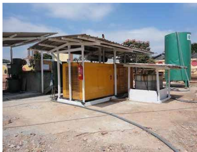
Figura 63 Gerador estacionário protegido contra intempéries e vazamentos. Fonte: Rosa (2013)
