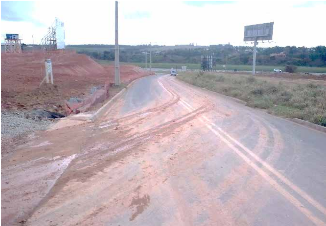
Figura 4 Evidências de sedimentos sendo carreados da obra para a via pública por portaria sem controle. Fonte: Rosa (2013)
