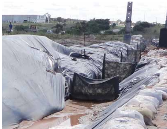
Figura 48 Barreira de sedimentos de membrana de geotêxtil ao longo da calha provisória da obra. Fonte: Rosa (2013)
