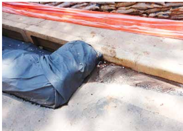
Figura 61 Exemplo de proteção de entrada da rede pluvial evidenciando a retenção de sedimentos. Fonte: Rosa (2012)
