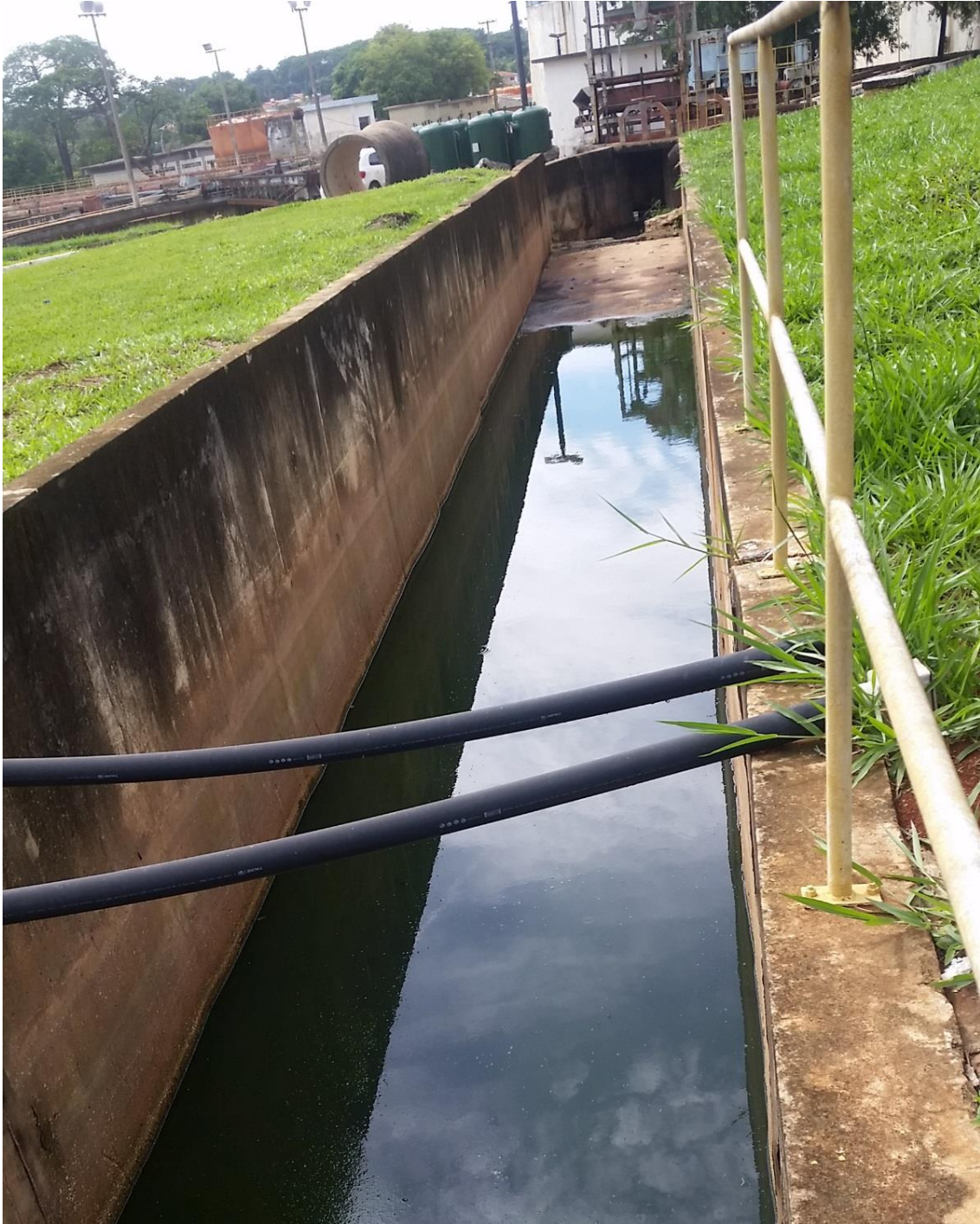
Foto 1 – Linha de by-pass
