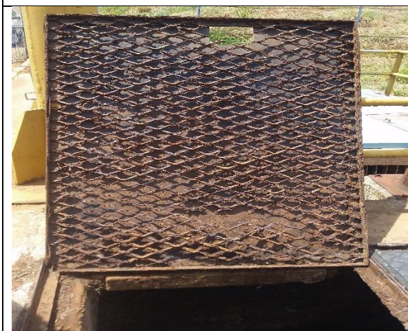
Foto 23 – Tampa oxidada – EEB.GAM.001
