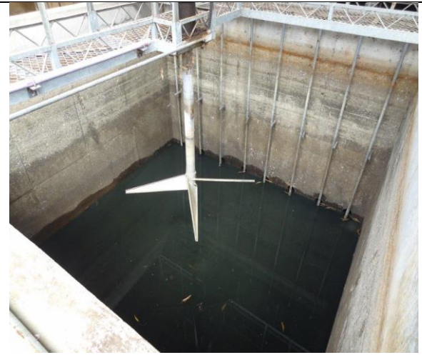
Foto 8 – Câmara de flotação fora de operação.
