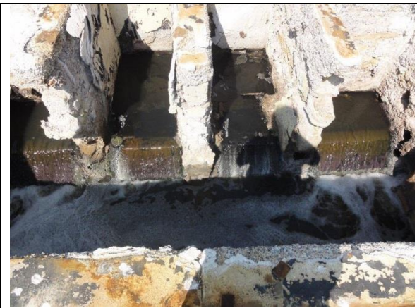
Foto 4 – Caixa de saída oxidada.
