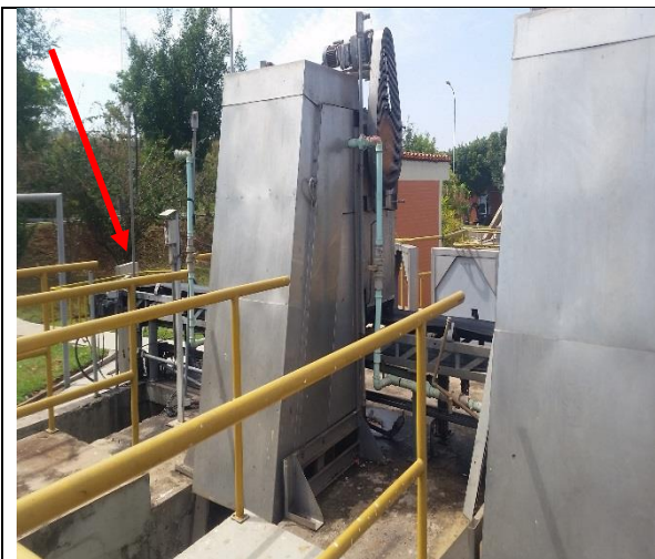
Foto 11 – Local onde deveria estar instalada a terceira esteira.
