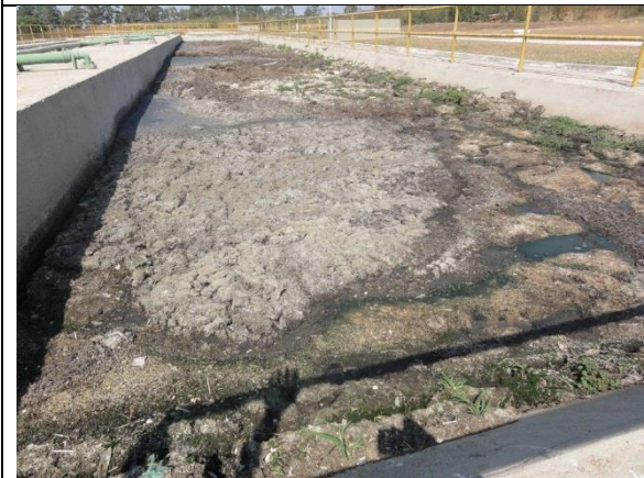
Foto 5 – Acúmulo de sujeira nos RAFAs.
