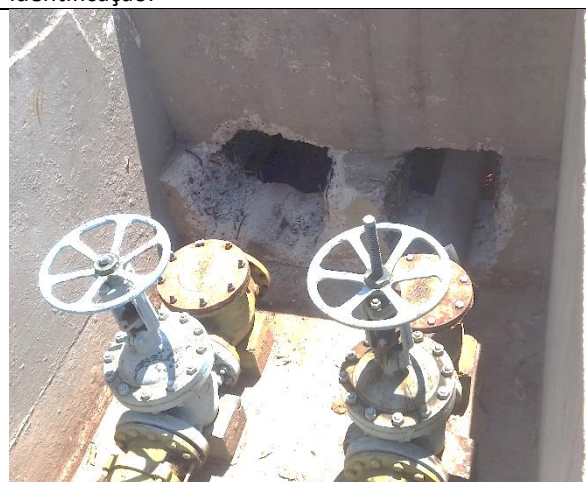
Foto 25 – Barrilete em manutenção – EEB.GAM.002
