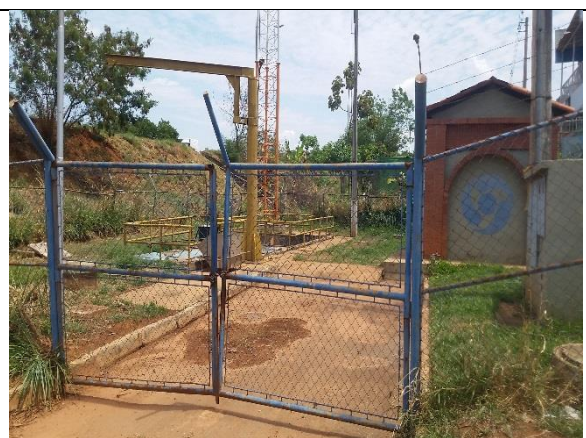
Foto 22 – Entrada da EEB.GAM.001 sem identificação.
