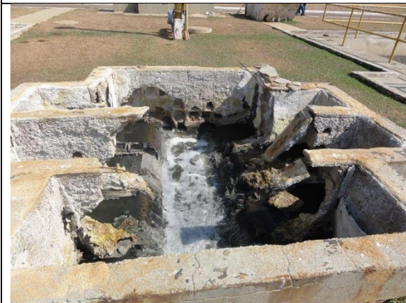
Foto 3 – Caixa de saída oxidada.
