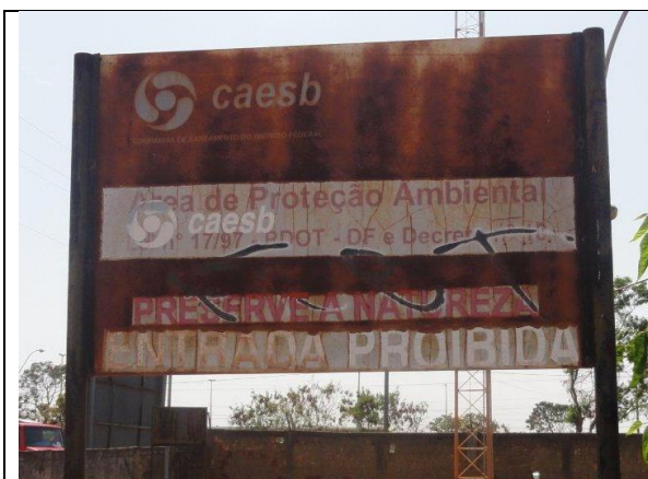
Foto 21 – Placa oxidada – EEB.STG.001
