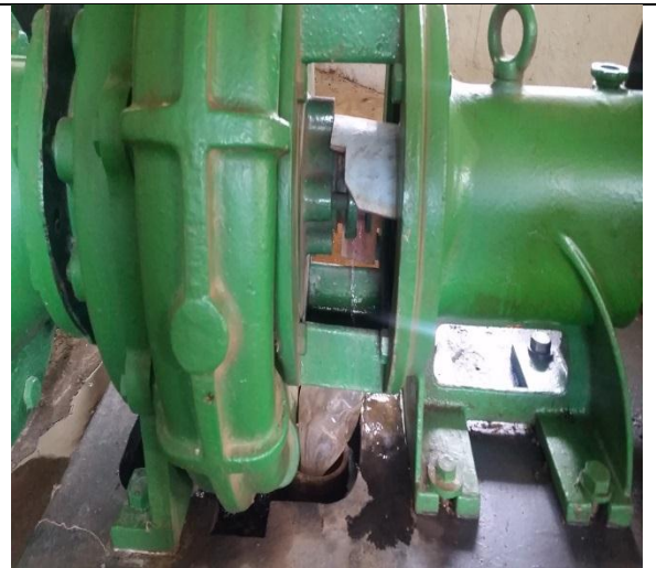
Foto 2 – Dreno da água de lubrificação do motor desentupido.
