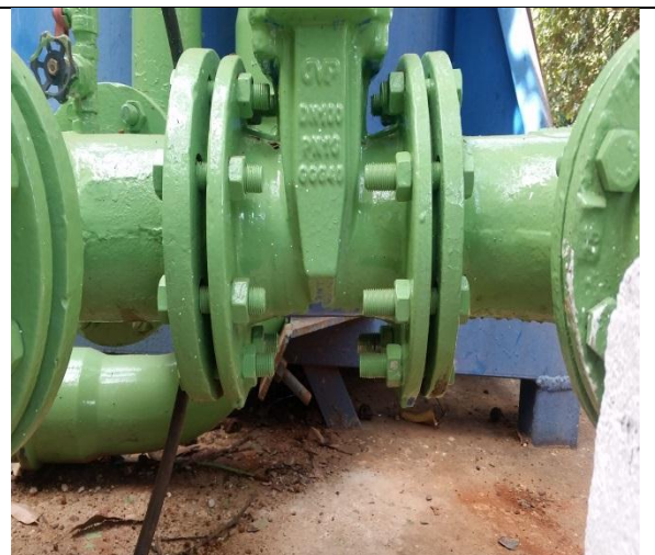
Foto 6 – Vazamento contido na válvula.
