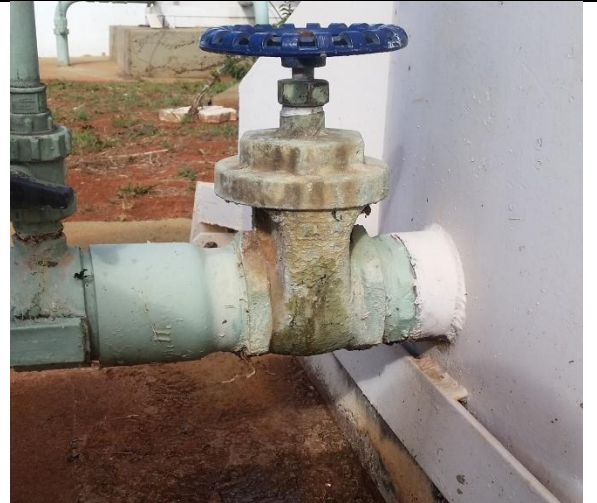
Foto 4 – Vazamento contido junto a válvula.
