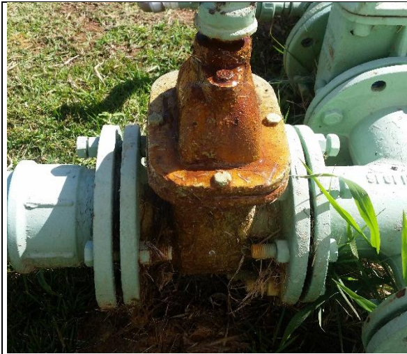
Foto 15 – Oxidação em válvula na UCP.CGS.001 (RF/COFA/004/2015).
