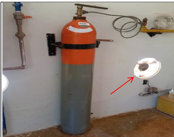
Foto 17 - Um dos exaustores fora de operação. (RF/COFA/004/2015).
