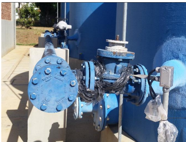
Foto 19 - Atuador de válvula de um dos filtros em manutenção (RF/COFA/004/2015).
