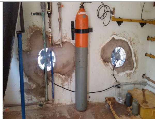
Foto 18 – Exaustores em operação.
