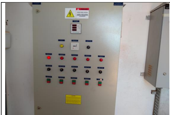
Foto 15 – Quadro do comando elétrico
