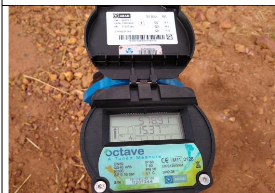
Foto 11 – Medidor de vazão EBO.SB1.008
