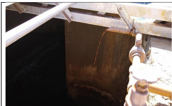
Figura 2 – Adição de sulfato de alumínio
