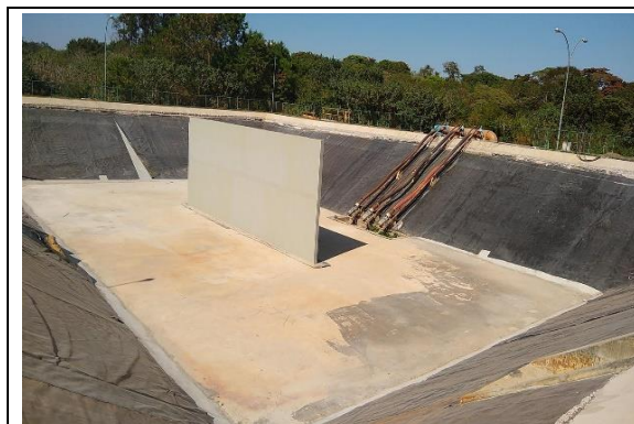
Figura 4 – Reator biológico (Tanque pulmão)
