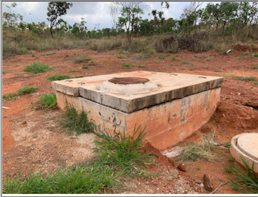
Foto 4 - Caixa de descarga da adutora Alagado
