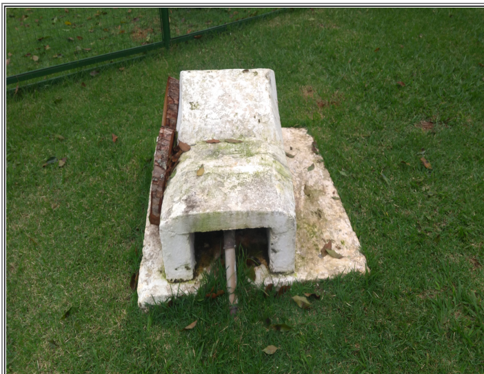
Foto 1 - Tubulação de saída do poço artesiano
