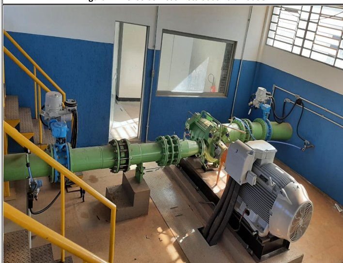
Figura 3 - Atuadores elétrico na tubulação de recalque das bombas
