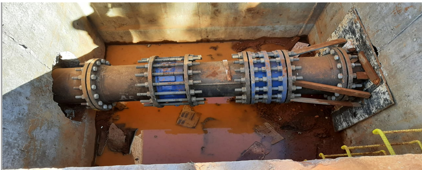
Figura 13 - Trecho final da tubulação da subadutora SAT.GCS.034
