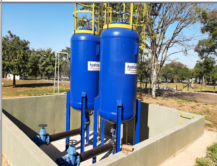
Figura 6 - Reservatórios hidropneumáticos - RHO
