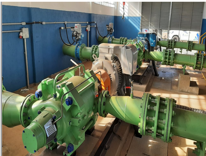
Figura 1 - Novas bombas instaladas na unidade
