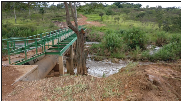
Fig. 04: Ponte sobre o rio Melchior que conduz o restante da tubulação não atingida. Efluente derramado no Rio Melchior.
