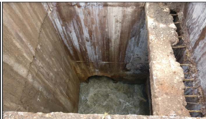
Fig.06: Detalhe do interior da caixa de interligação.
