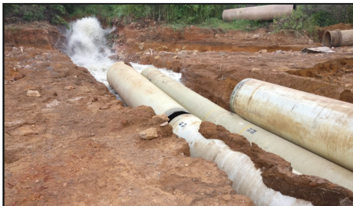
Fig.01: Tubulação PFV desmoronada ainda sobre o leito.
