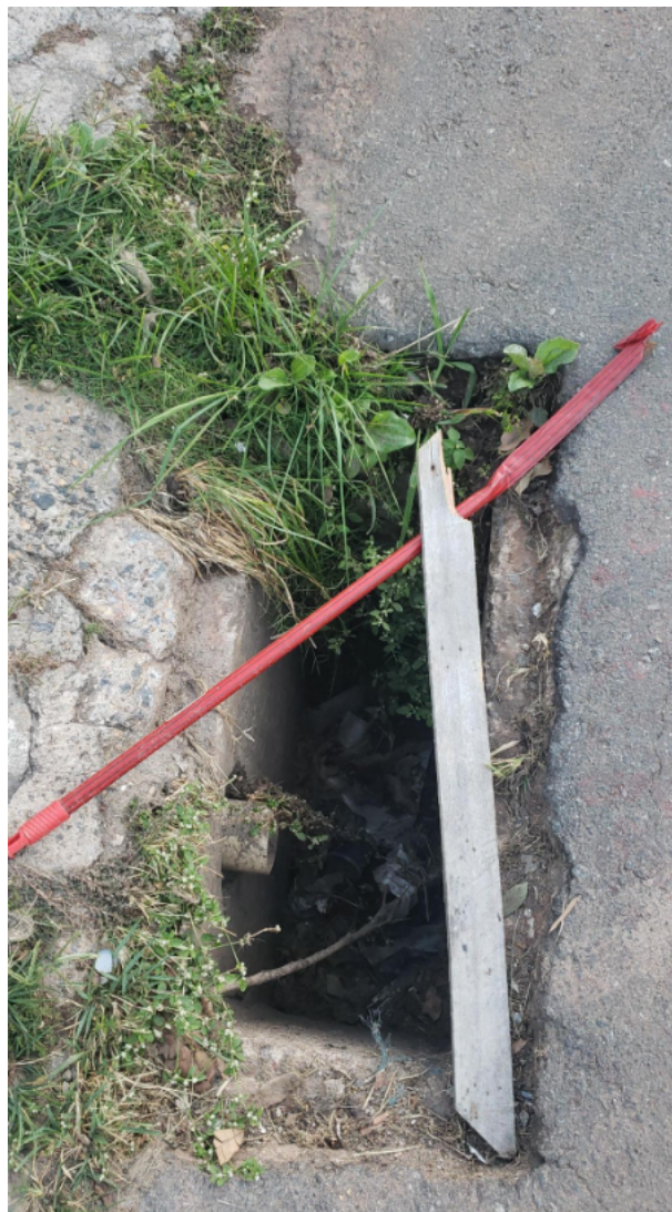
Foto 3 - Detalhe do buraco: possui um cano pvc não identificado saindo de uma residencia (possivelmente da casa 30).
