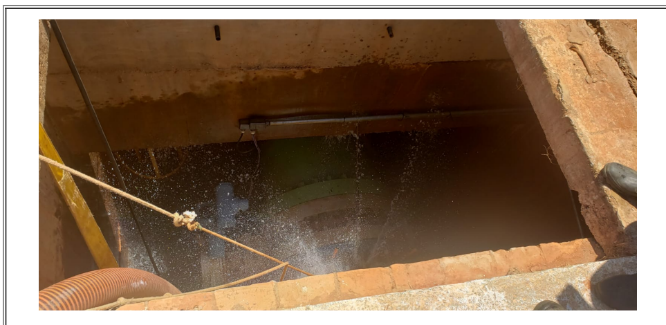
Foto 1 - Vazamento na válvula da adutora
