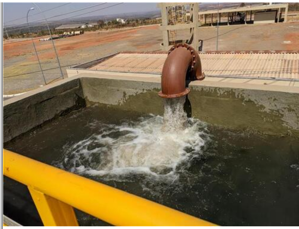
Foto 2 - Entrada de água bruta na ETA e de água de recirculação da lavagem dos filtros
