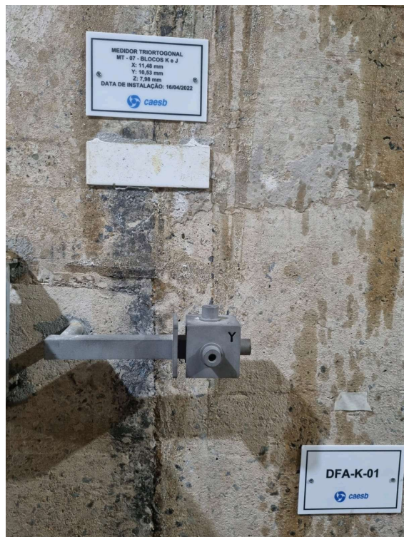
Foto 14 - Piezômetro - PZ - F - 01 - Inclinação 20° (Profundidade 8,56m) Piezômetro - PZ - F - 02 - Inclinação 20° (Profundidade 5,42m)
