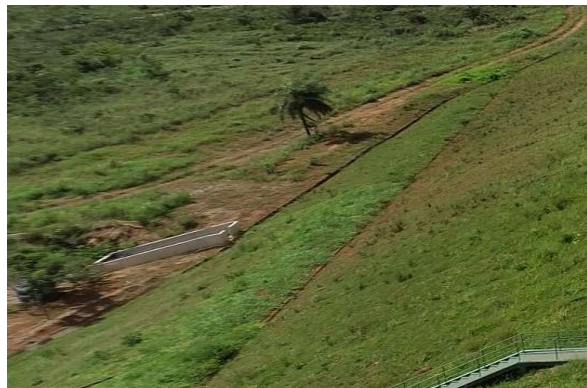
Foto 18 - Caixa de concreto para proteção de duas válvulas nova adutoras da saída do reservatório
