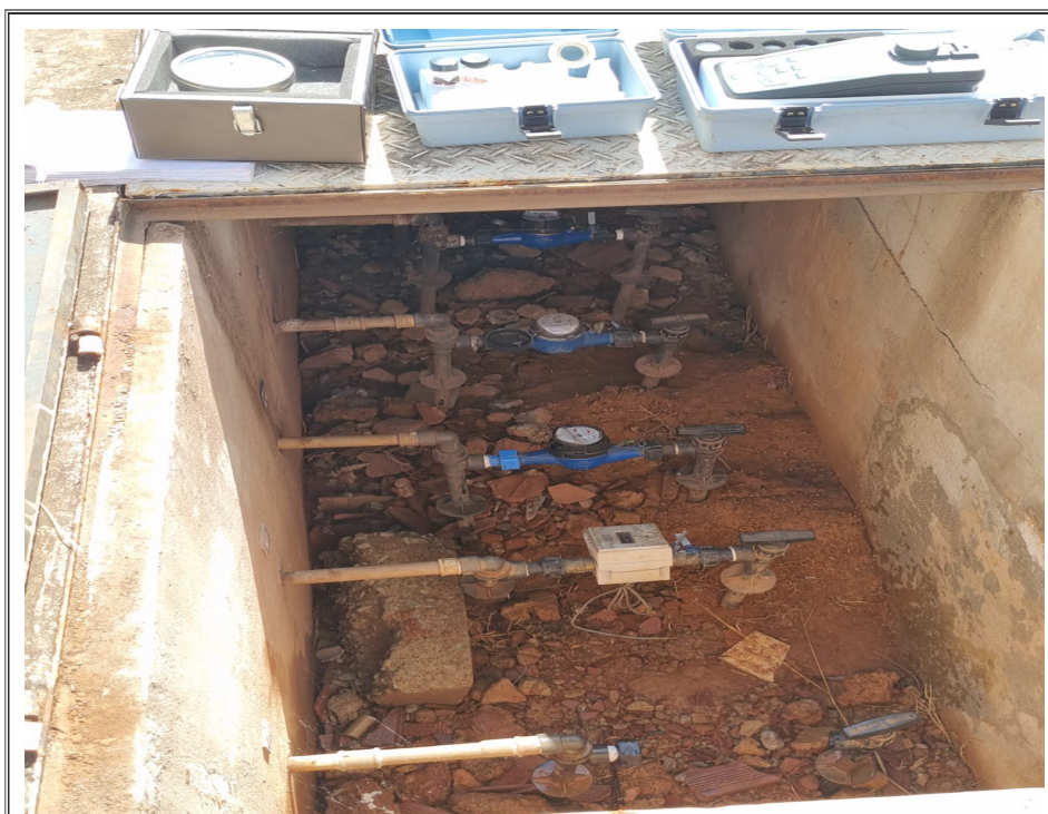
Foto 3 - Realização de testes no ponto de distribuição da rede de um condomínio na SMPW Q. 8
