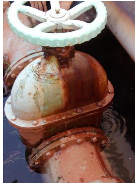
Figura 35 - Vazamento em registro de manobra no RAP.PPL.001, abr/2017.
