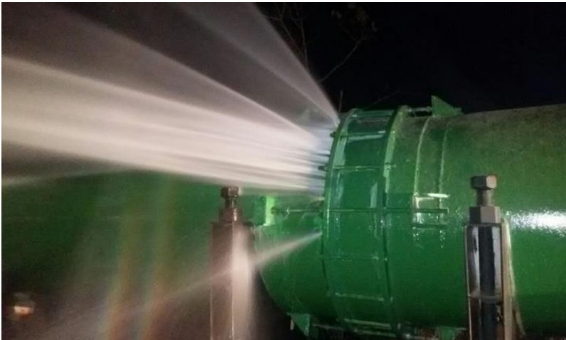
Figura 36 - Vazamento na adutora de água bruta do Santa Maria, out/2017.
