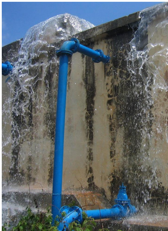
Figura 23 - Extravasamento de reservatório.
