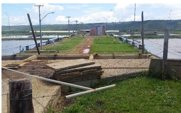
Caixa de distribuição danificada
