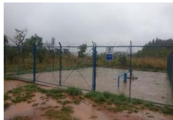
Figura 5 - Poço EPO.002 (Núcleo Rural Rajadinha)
