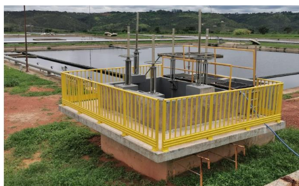
Caixa de distribuição recuperada
