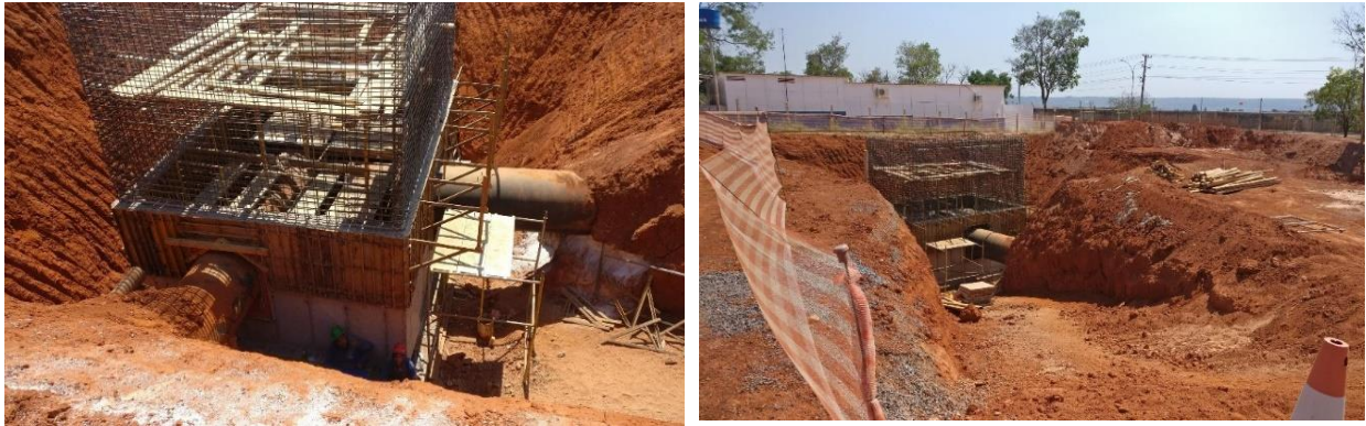
Figura 3 – Caixa de interligação n. 03
