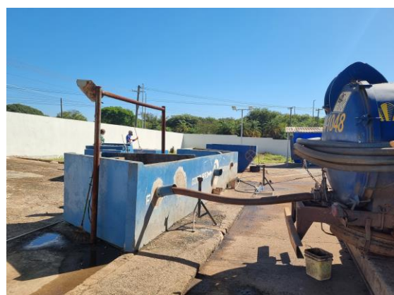
Figura 21 - Detalhe do mangote no local destinado ao descarte para lodo de fossas.
