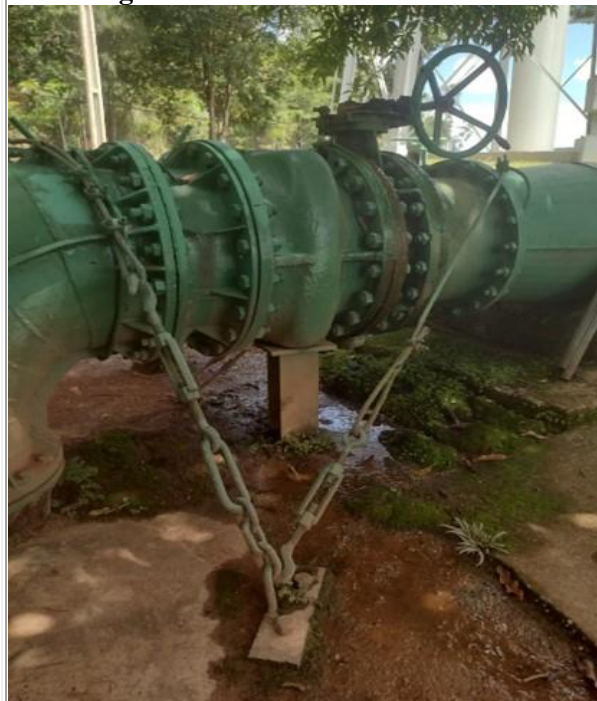
Figura 60- Vazamento na válvula II
