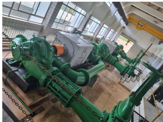
Figura 58- Três motores de bombeamento de água da elevatória de Santa Maria
