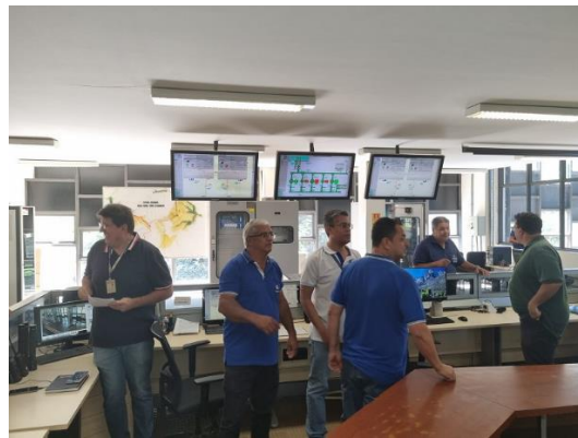
Figura 51- Sala operacional por meio de sistemas
