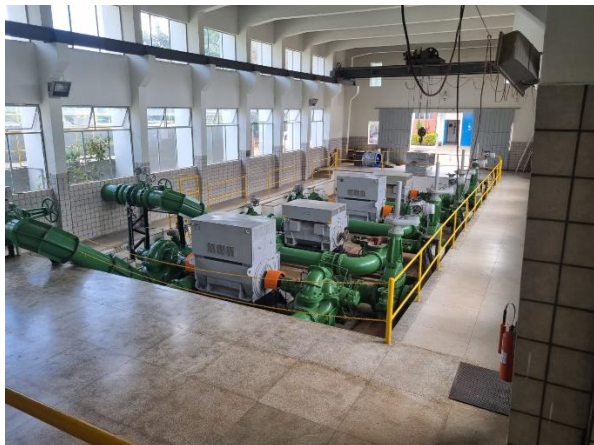
Figura 57- Quatro motores de bombeamento de água da elevatória do Torto
