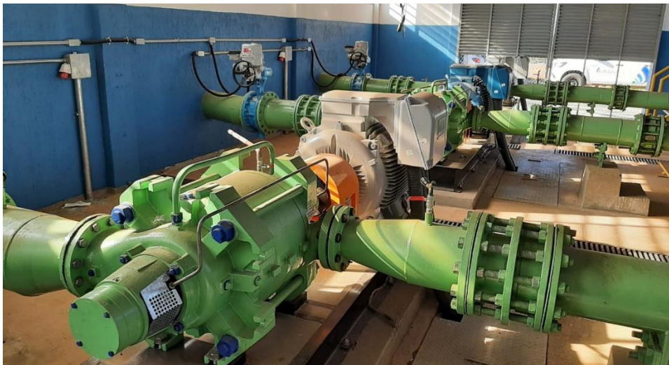
Figura 12 - Novas bombas instaladas na Elevatória Lago Norte 2.
