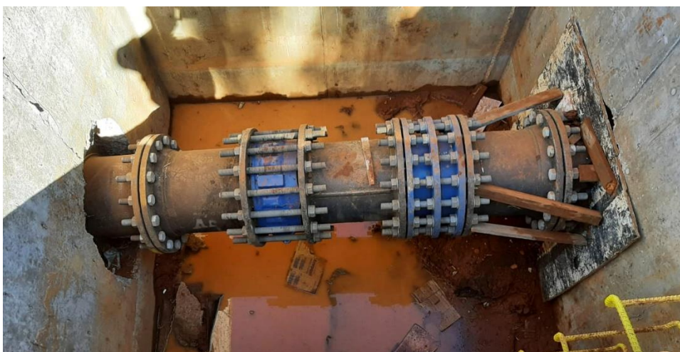
Figura 13 - Trecho final da tubulação da subadutora SAT.GCS.03.
